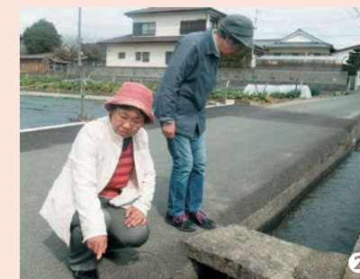
通行者が転落の恐れがあると声がよせられた水路
